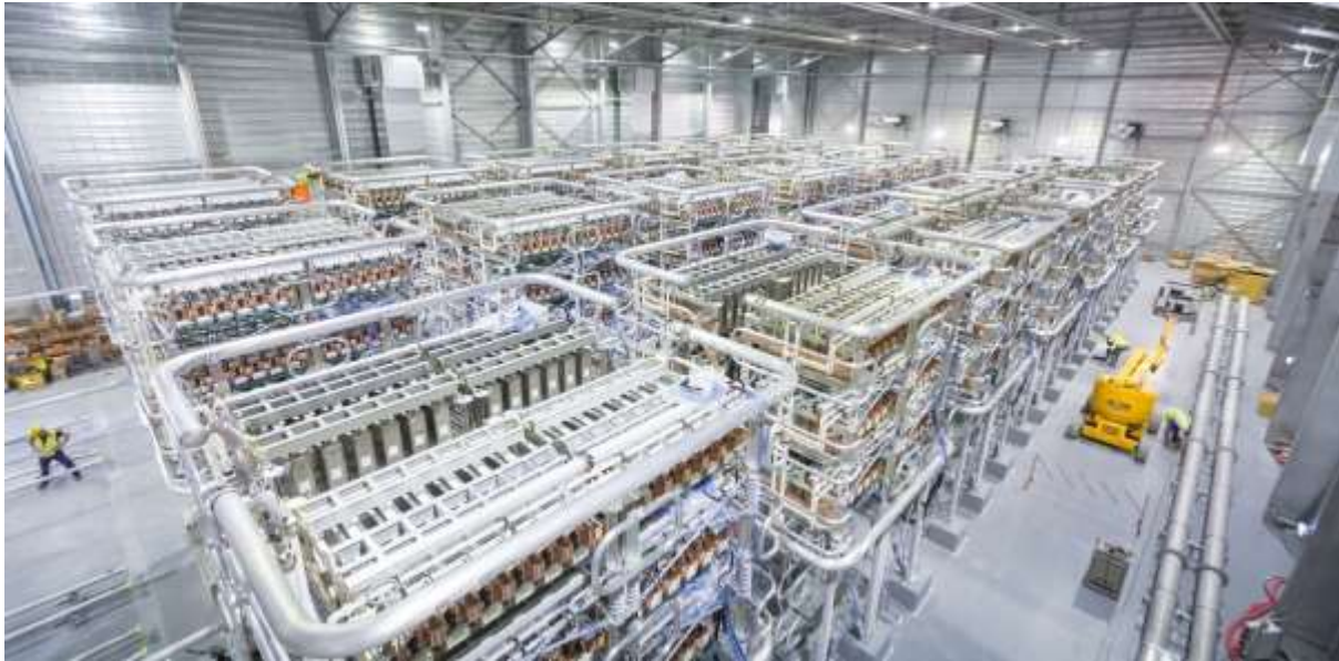
شکل ۳- نمونه یک تالار درگاه (Valve hall) در یک ایستگاه مبدل HVDC
