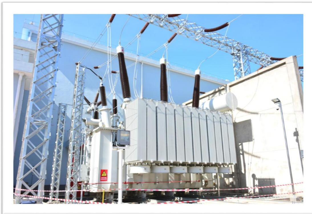
شکل ۱۱. ایستگاه فرعی با عایق گاز در کنیا
